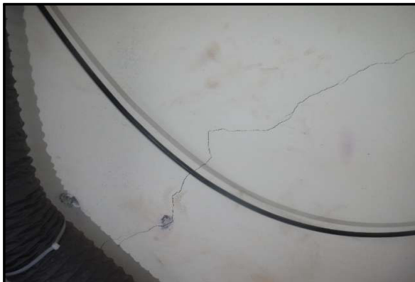
사진 15 지하1층 창고 벽체 현황번호 4 균열
