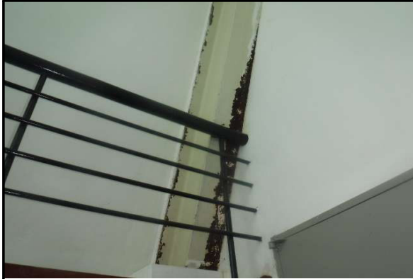
사진 19 지하1층 계단실 기둥 현황번호 8 강재 표면부식
