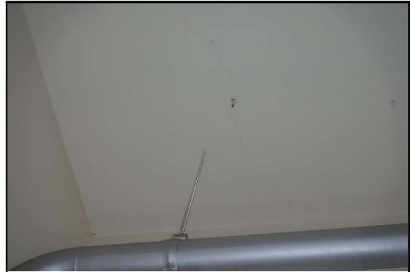
사진 14 지하1층 창고 상부슬래브 현황번호 3 균열
