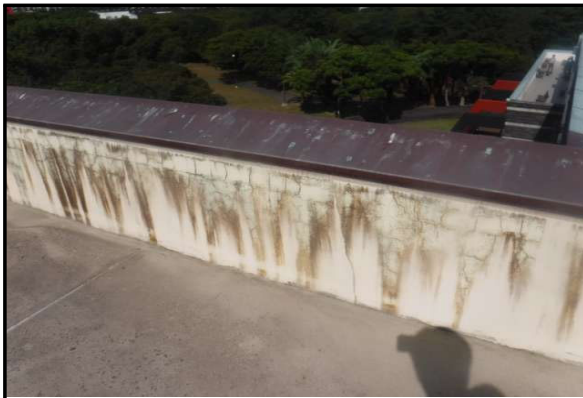
사진 1 지붕층 옥상 난간 현황번호 1 망상균열
