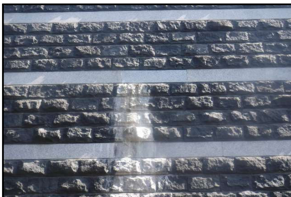
사진 11 지상1층 외부 벽체 현황번호 10 마감석 이격 및 백태
