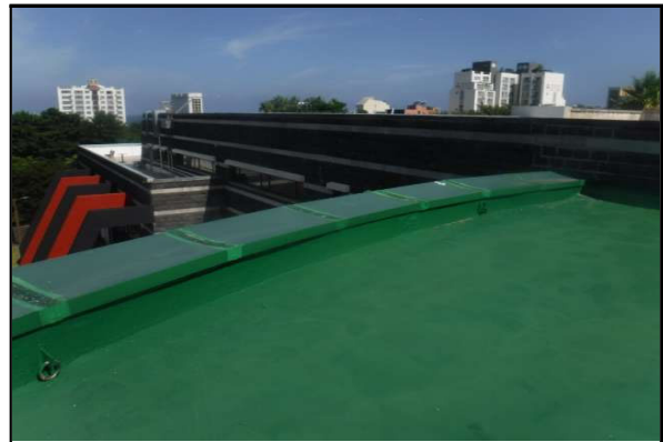
사진 2 지붕층 옥상 난간 현황번호 2 높이부족, 전반적
