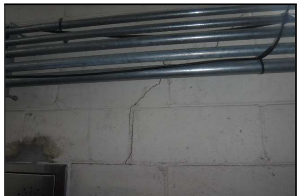
사진 12 지하1층 기계실 조적벽체 현황번호 1 균열
