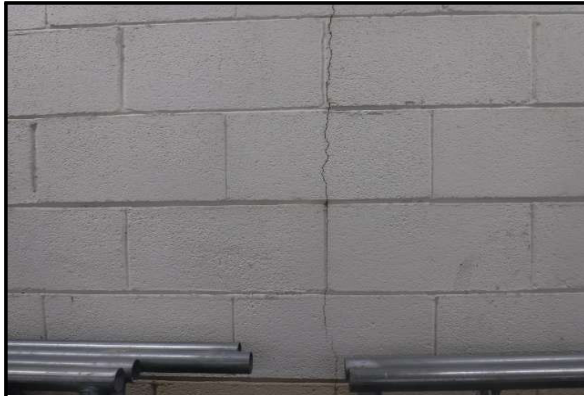
사진 13 지하1층 복도 조적벽체 현황번호 2 균열
