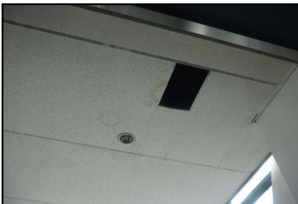
사진 5 지상1층 복도 천장 현황번호 3 텍스 누수흔적
