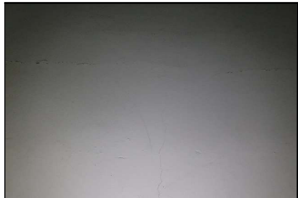
사진 16 지하1층 발전기실 벽체 현황번호 5 균열
