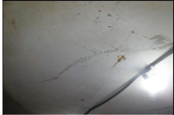
사진 20 지하1층 PIT 상부슬래브 현황번호 11 균열
