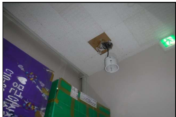
사진 6 지상1층 창고 천장 현황번호 4 조명기구 고정불량
