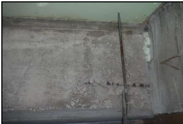
사진 9 지상1층 창고 상부보 현황번호 7 철근노출 및 부식
