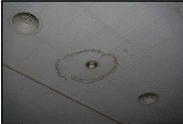
사진 7 지상1층 창고 천장 현황번호 5 마감재 누수흔적
