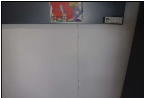
사진 3 지상2층 복도 기둥+조적벽체 현황번호 1 Joint 이격
