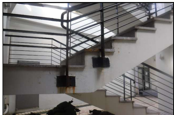
사진 18 지하1층 외부 계단 현황번호 7 난간 부식
