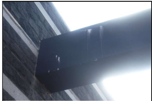
사진 4 지상1층 외부 상부보 현황번호 1 백태
