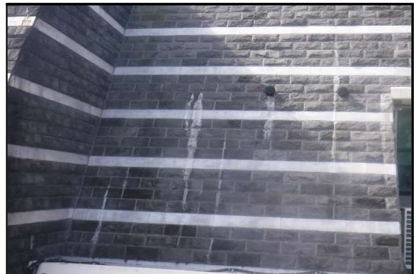
사진 10 지상1층 복도 천장 현황번호 9 텍스 누수흔적
