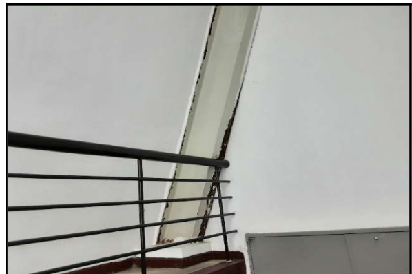
사진 16 지하1층 계단실 기둥 현황번호 8 강재 표면부식
