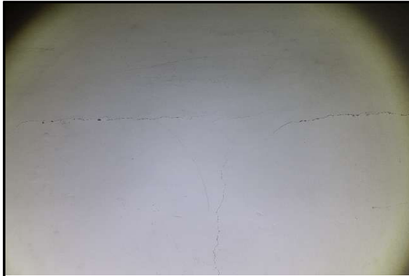
사진 13 지하1층 발전기실 벽체 현황번호 5 균열
