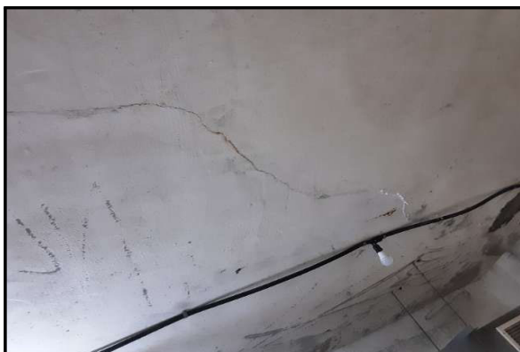
사진 17 지하1층 PIT 상부슬래브 현황번호 11 균열
