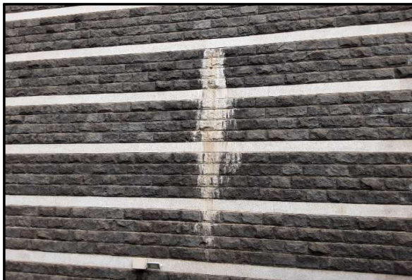
사진 9 지상1층 외부 벽체 현황번호 10 마감석 이격 및 백태
