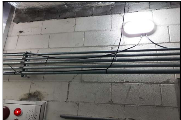
사진 10 지하1층 기계실 조적벽체 현황번호 1 균열
