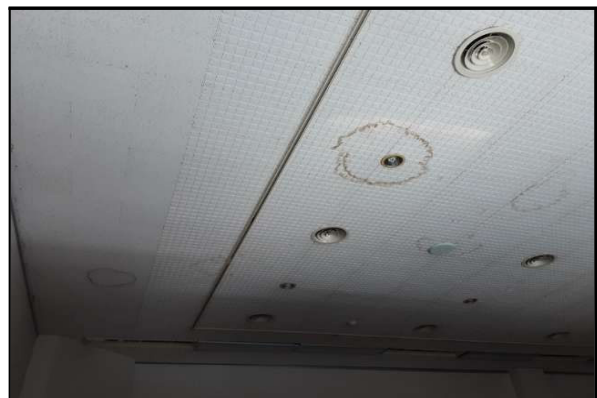
사진 6 지상1층 창고 천장 현황번호 5 마감재 누수흔적
