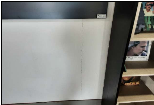
사진 1 지상2층 복도 기둥+조적벽체 현황번호 1 Joint 이격
