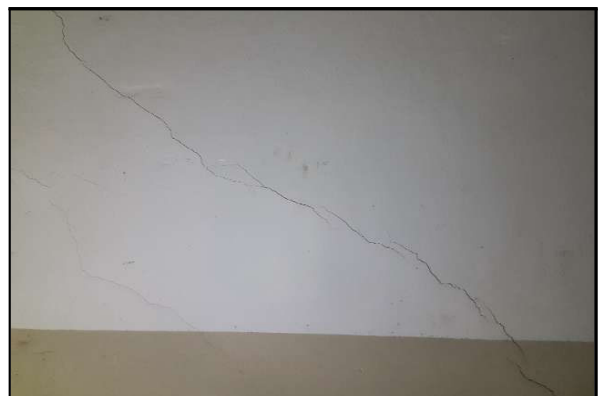
사진 18 지하1층 발전기실 벽체 현황번호 12 균열
