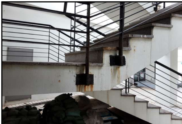
사진 15 지하1층 외부 계단 현황번호 7 난간 부식
