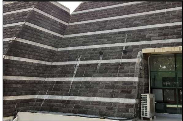
사진 8 지상1층 외부 외벽 현황번호 9 백태상태
