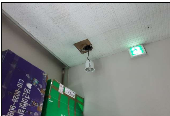
사진 5 지상1층 창고 천장 현황번호 4 조명기구 고정불량
