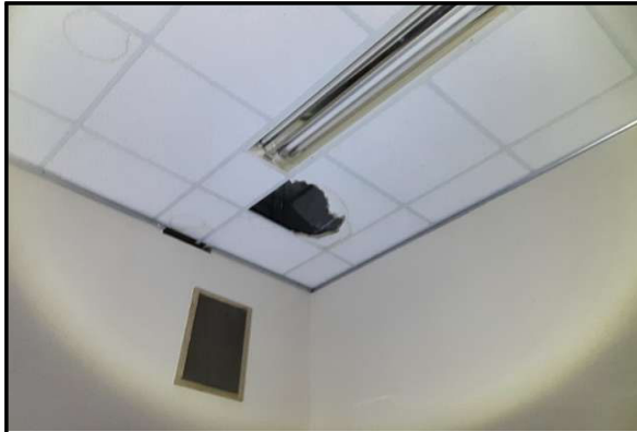
사진 7 지상1층 창고 천장 현황번호 8 마감재 탈락
