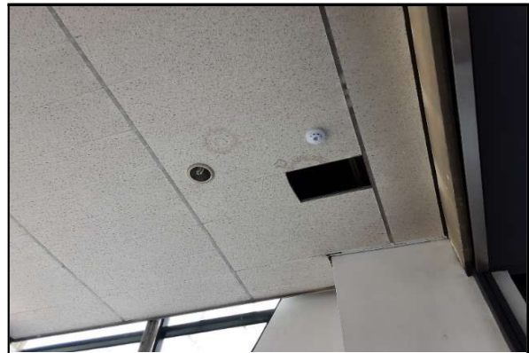
사진 4 지상1층 복도 천장 현황번호 3 텍스 누수흔적
